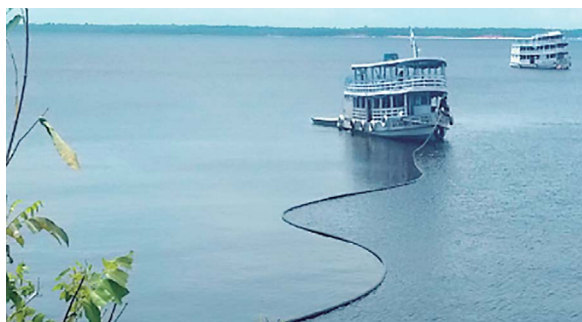
Infraestrutura de fibra óptica no leito dos rios amazônicos.
